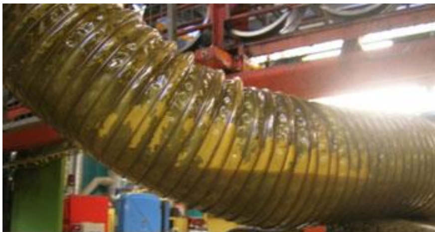
Bild 2. Ansamling av skärvätska i en svacka på flexibla anslutningen av maskin till frånluftskanalen.
